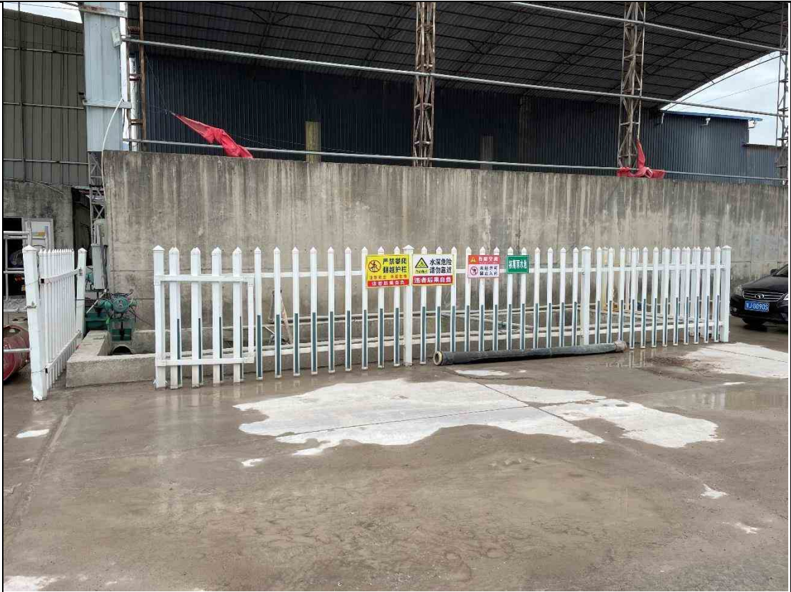
图 2.12-9 企业现状初期雨水池
