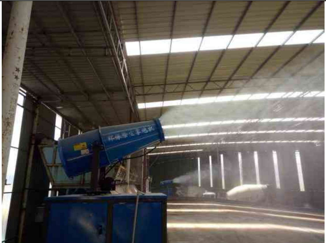
图 2.12-3 企业现状堆场设置除尘炮雾机
