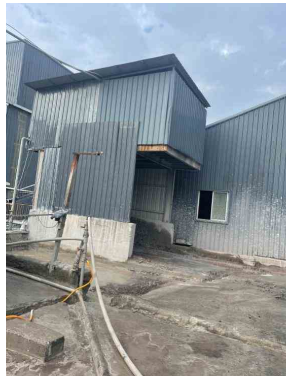
图 2.12-8 企业现状密闭压滤房
