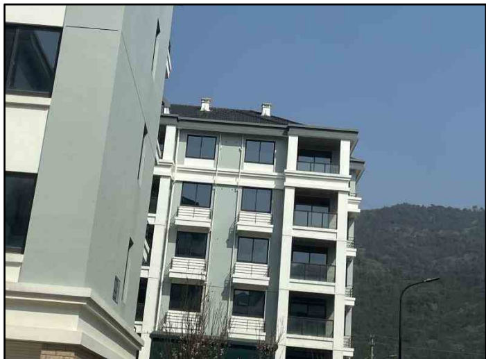
厨房专用烟道
